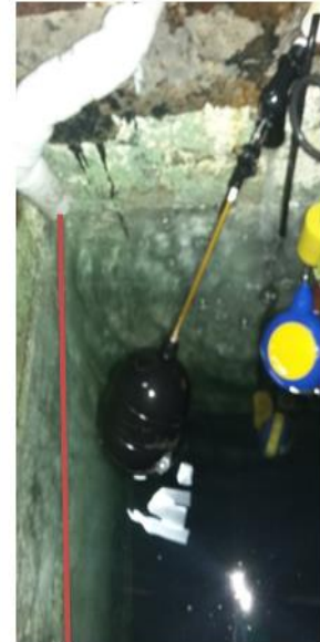
CAIDA DE AGUA PLUVIAL
